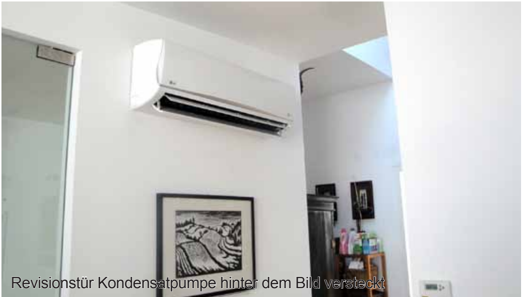
Vorher : Leitungen unterputz in Rigips-Wand verlegt. Pumpe hinter Türchen
